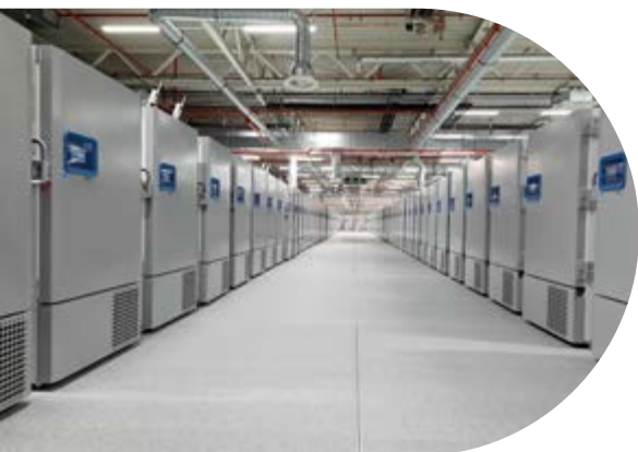
Präzise gekühlt: Industrielle Freezer in perfekter Reihenordnung – für höchste Qualität und Sicherheit im Lagerprozess.
